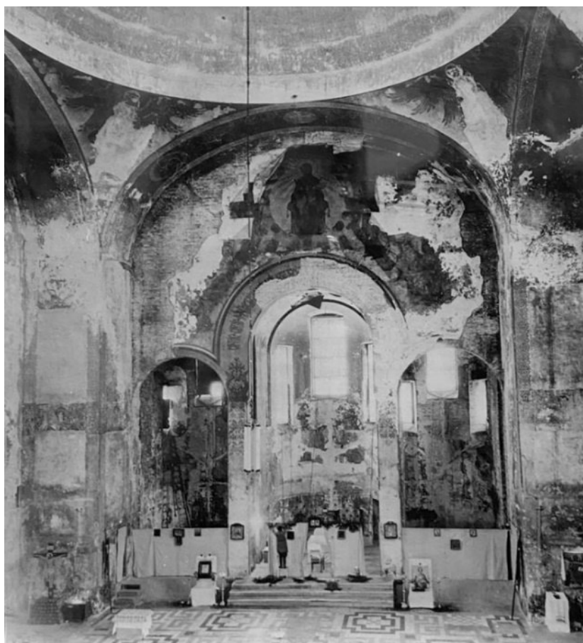
Ил. 1. Состояние росписи после передачи здания церкви, 1990 г.
